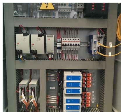
EQUIPOS DE COMUNICACION, SWITCH Y PASARELAS
