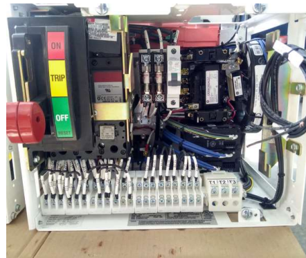
ALAMBRADO DE CUBÍCULOS
